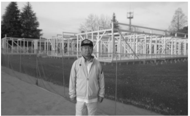
南三陸町歌津中学校グラウンド内仮設住宅建設現場にて
